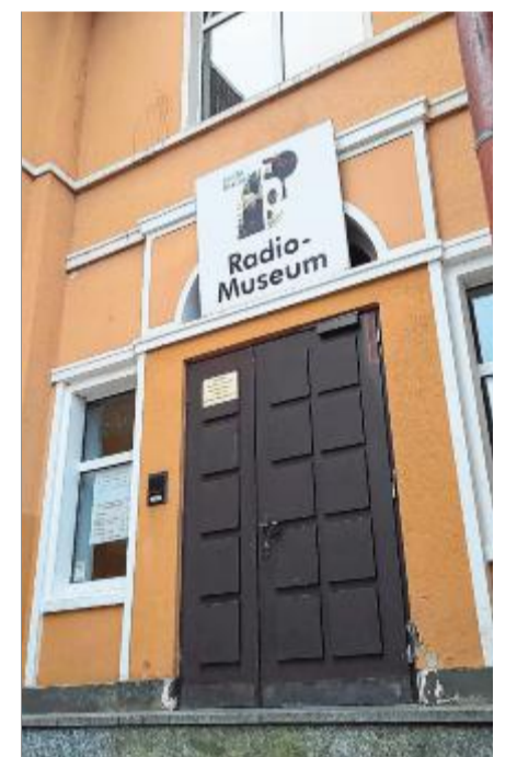
An der Bahnhofstraße in Bad Laasphe herrscht Funkstille. Das Internationale Radiomuseum von Hans Necker hat Sendepause – wegen Brandschutzmängel. Das betrifft auch die anderen Mieter in dem Gebäude. Foto: howe
